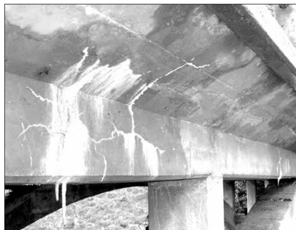
Eine Sanierung der Feschelbachbrücke ist unumgänglich.
